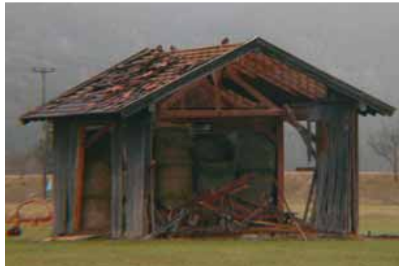
Vom Föhnsturm am 16.11.2002 zerstörte Hütte im Landkreis Garmisch-Partenkirchen (Quelle: W. Stieglmair, München)
