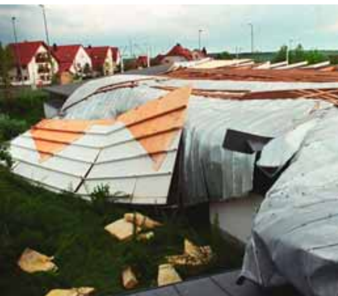
Abbildung 16: Abgewehtes Pultdach einer Schule in einem Neubaugebiet
