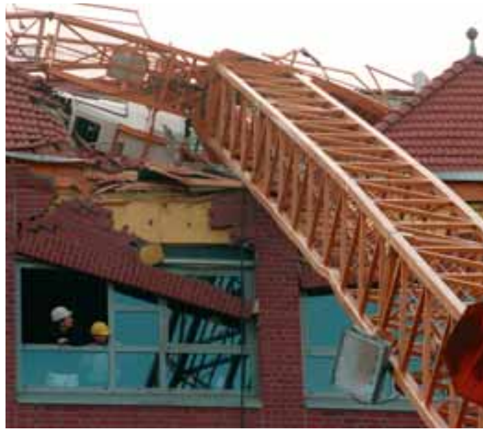
Sturm DANIELA ließ am 21.02.1997 einen Baukran auf das Dach eines Krankenhauses in Köln-Niehl stürzen (Quelle: dpa).
