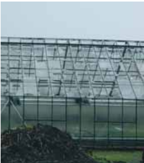
Hagelschlag zerstörte am 31.07.2004 zahlreiche Gewächshäuser südöstlich von Hamburg (Quelle: T. Schwarz, Hamburg).
