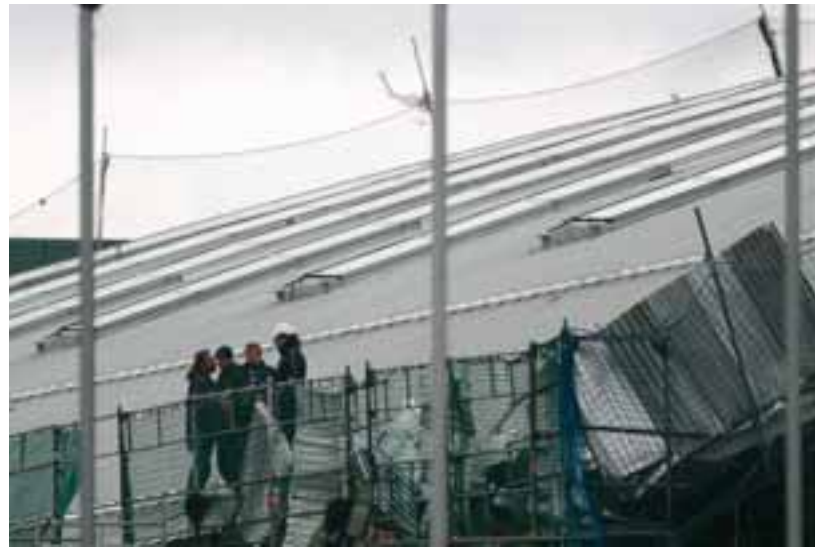
Teile des Daches des im Bau befindlichen Terminal 2 am Hamburger Flughafen wurden vom Sturm am 21.03.2004 weggerissen (Quelle: ddp).
