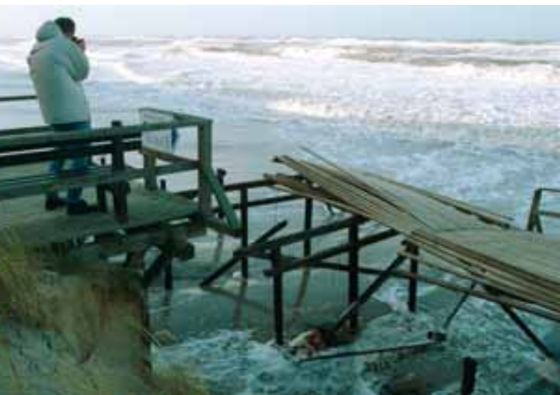
Durch den Sturm KERSTIN am 30.01.2000 beschädigte Strandtreppe auf Sylt (Quelle: Sylt-Picture)
