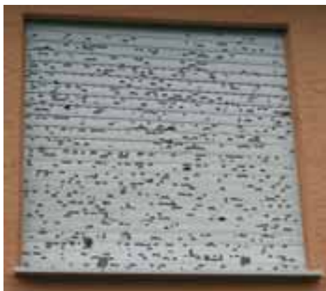
Abbildung 18: Hagelkörner werden durch Windböen oft auch horizontal beschleunigt und bewirken so Schäden unter anderem an Rolläden wie hier nach einem Hagelunwetter am 08.07.2004 in Stockach (Quelle: J. Braun, Stockach).
