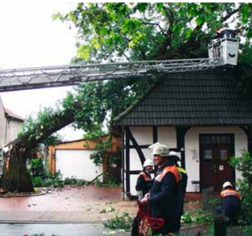
Durch eine umgestürzte Eiche zerstörtes Dach nach einem Unwetter im Juni 1998 (Quelle: C. Weber, Minden)
